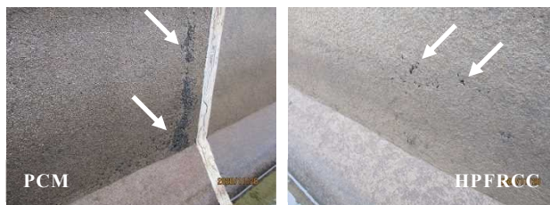
Fig.1 コンクリートの露出に至った無機系表面被覆材の摩耗 Abrasion of inorganic surface coating materials that caused concrete exposure
